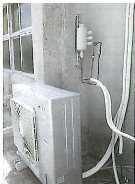
初期1号機取付(テスト用) 某メーカー 4馬力
