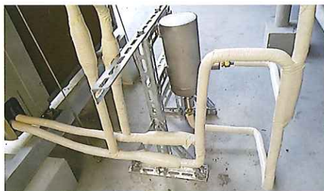
沖縄県内某遊戯店 低床設置事例
